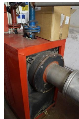
Figura 4.112 - Particolare del generatore di calore
