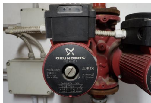
Figura 8.7 – Particolare pompe di circolazione
