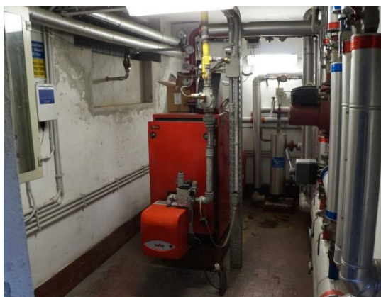
Figura 4.11 - Generatore di calore
