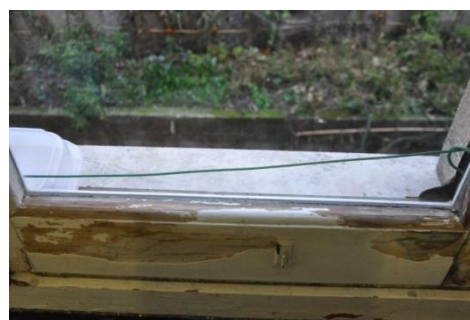
Figura 8.3 – Particolare infissi in legno da sostituire
