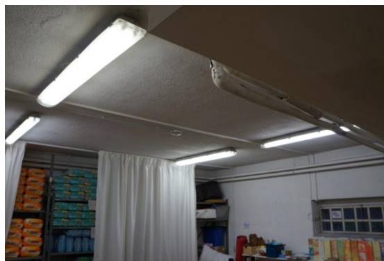
Figura 4.16 - Particolare dei corpi illuminanti ubicati nel magazzino al piano terra
