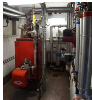
Figura 8.5 – Particolare della centrale termica
